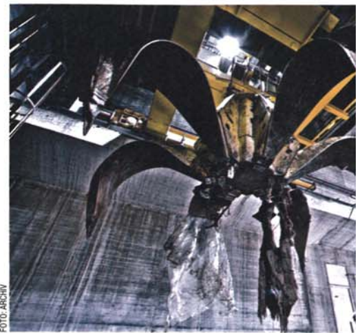
Greifer in einer Müllverbrennungsanlage
